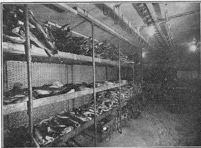
FIG. 3. — CHAMBRE FROIDE DU PAQUEBOT « NORMANDIE » POUR LA CONSERVATION DES POISSONS
