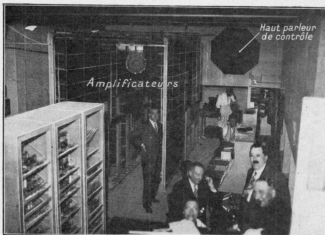
FIG. 6. — VUE DE LA SALLE DES AMPLIFICATEURS
