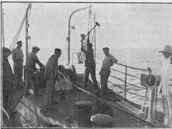
FIG. 8. — FIN DE LA POSE DU CÂBLE SOUS-MARIN MARSEILLE-ORAN, PAR LE CABLIER « AMPÈRE »
