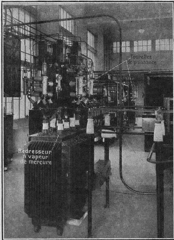
FIG. 5. — VUE DE LA SALLE D'ÉMISSION, MONTRANT, DE L'AVANT À L'ARRIÈRE, LES REDRESSEURS À VAPEUR DE MERCURE, UNE PREMIÈRE TOURELLE DE PUISSANCE, LES CIRCUITS OSCILLANTS ET, TOUT AU FOND, LA DEUXIÈME TOURELLE DE L'ÉTAGE DE PUISSANCE
