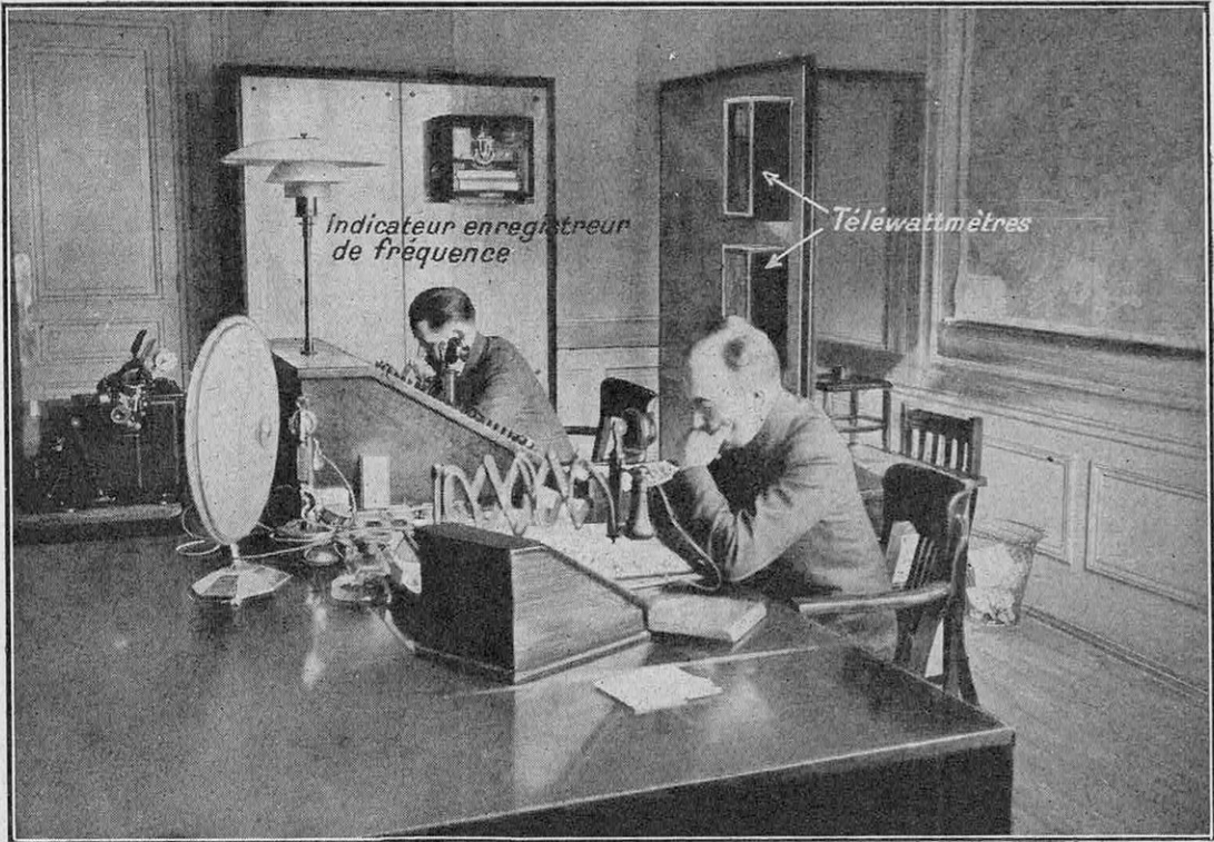
FIG. 5. — LE BUREAU DU « DISPATCHING » : AU FOND, LES APPAREILS DE MESURE
