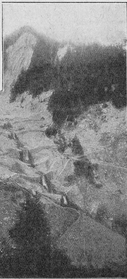
BARRAGE DE FIXATION DE MATÉRIAUX ENTRAÎNÉS CONSTAMMENT DANS LE RAVIN DES ARANDELLYS (TORRENT DE LA GRIAZ)
