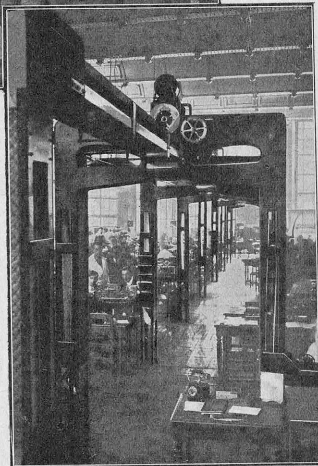
VUE GÉNÉRALE DU TRANSPORTEUR « KRIÉGER » DANS L'UNE DES SALLES DU CENTRAL TÉLÉGRAPHIQUE DE PARIS
