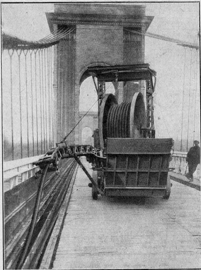
DÉROULEMENT DU CABLE SUR LE PONT DE BOMPAS, SUR LA DURANCE, PRÈS D'AVIGNON
